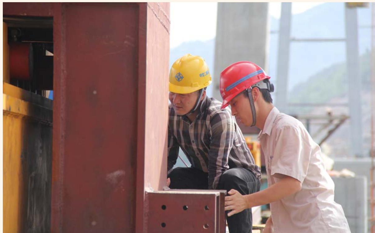
项目总工王超在顶推工程中与施工人员仔细查看顶推设备的运行情况
